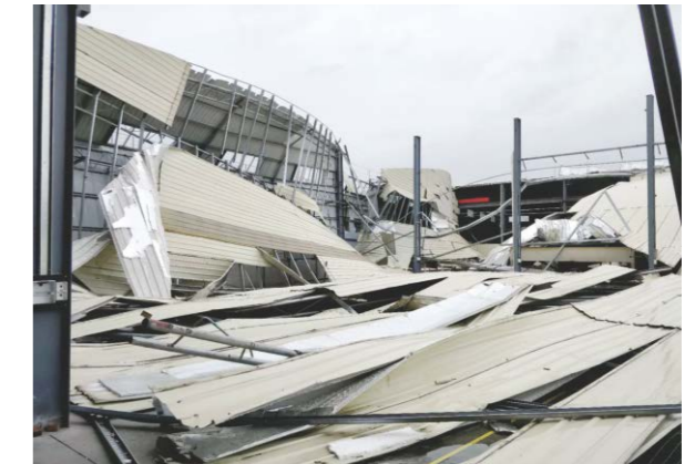
厂房建筑现场倒塌损失情况
